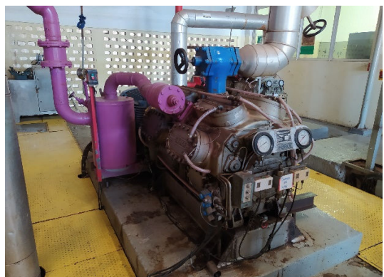
Vista do compressor
